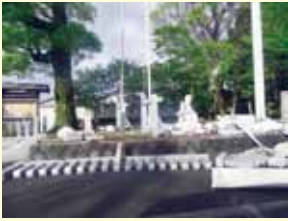
神社の塀が崩れている様子
